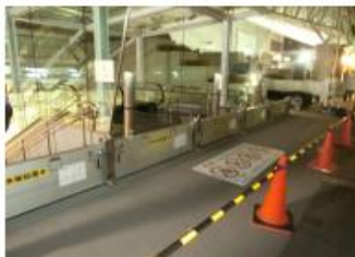
止水板の設置・訓練 (安心・安全)
